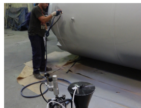
Réservoir à gravité
